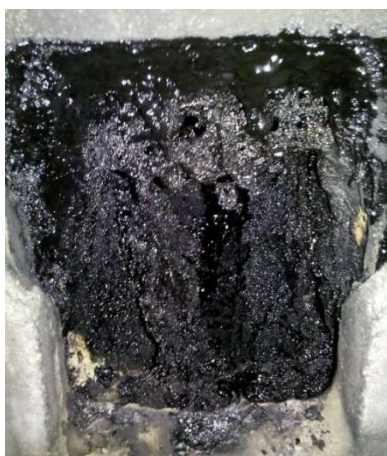
Glanzruß aus Sicht eines Kehrtürchen im Dachboden
